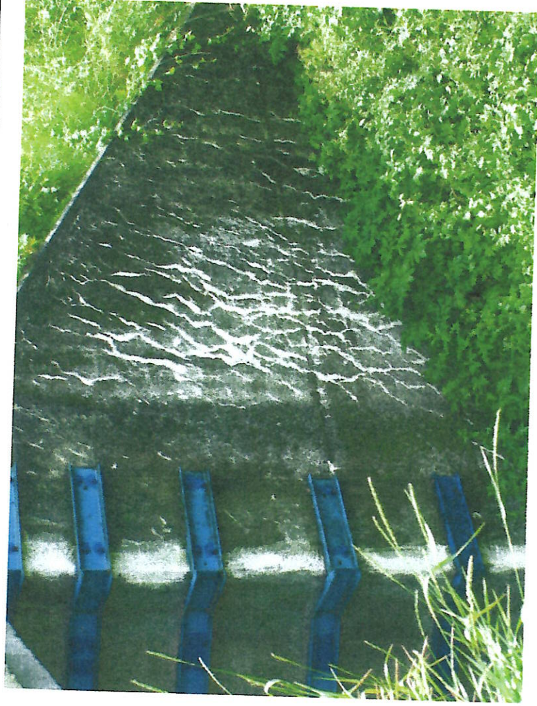
Fot. 5. Wylugowania i zanieczyszczenia powierzchniowe skrzydeł betonowych. Nie wykoszone skarpy i teren pod wiaduktem.
